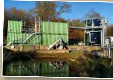
Déi nei Kläranlag. Foto: Sidest
